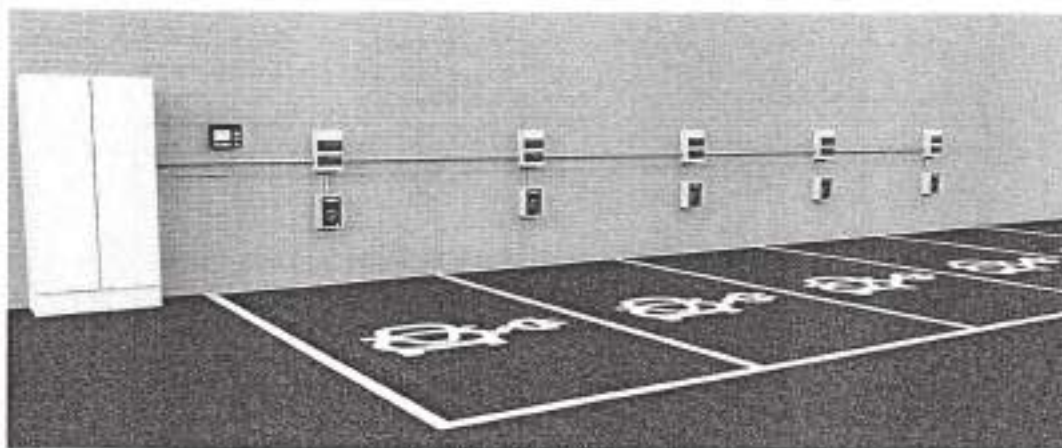
Figura 4: Allestimento a parete
